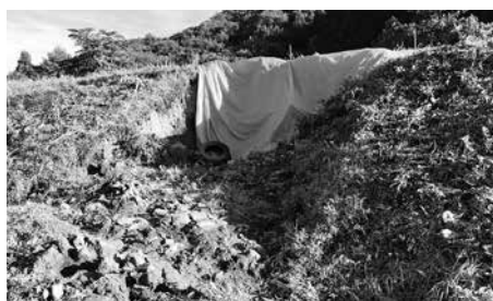
▲法面が崩れた農地
