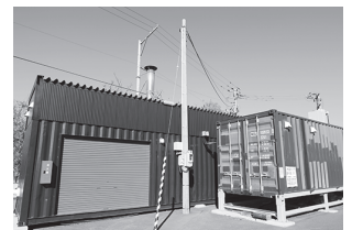
▲「蔵の湯」の 木質バイオマスボイラー
