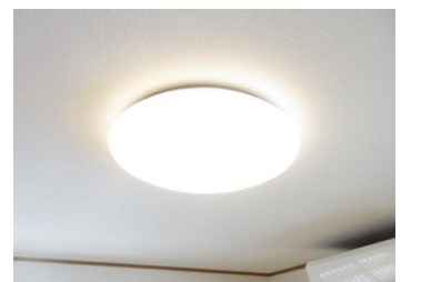
⑫全照明LED採用 省エネルギー対策
