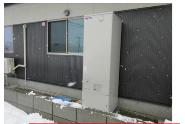
⑭エコキュート採用 省エネルギー対策 オール電化住宅の実現
