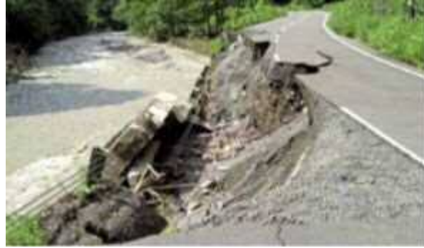
【豪雨による道路の崩落】
