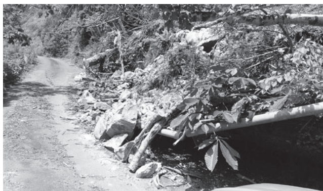
▲朝倉地内崩落現場
