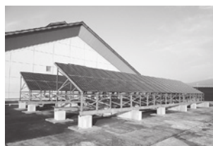
▲ 押切川公園体育館の太陽光発電設備
