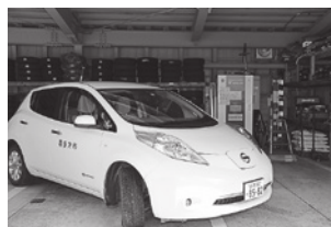
▲ 公用車の電気自動車と充電設備
