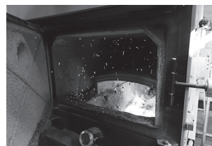
▲ 木質バイオマスボイラの 可燃装置
