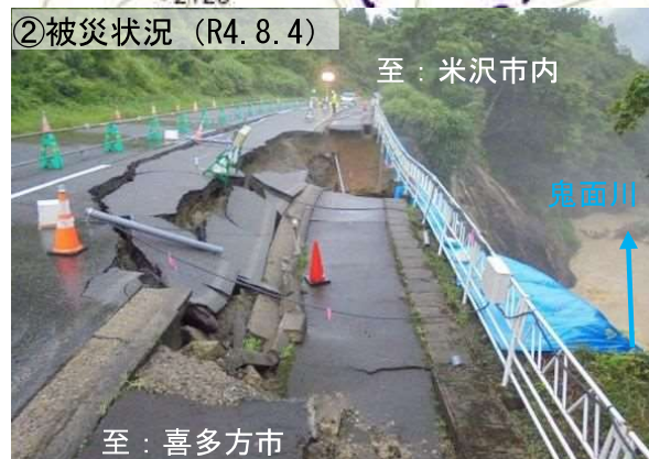
③被災状況 (R4. 8. 4)
