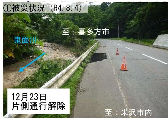
②被災状況 (R4. 8. 4)
